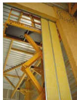
Pose des bacs Technostar II à la verticale, de part et d'autre d'une ossature bois lamellé-collé, sur une hauteur de 7 mètres sans reprises intermédiaires.
